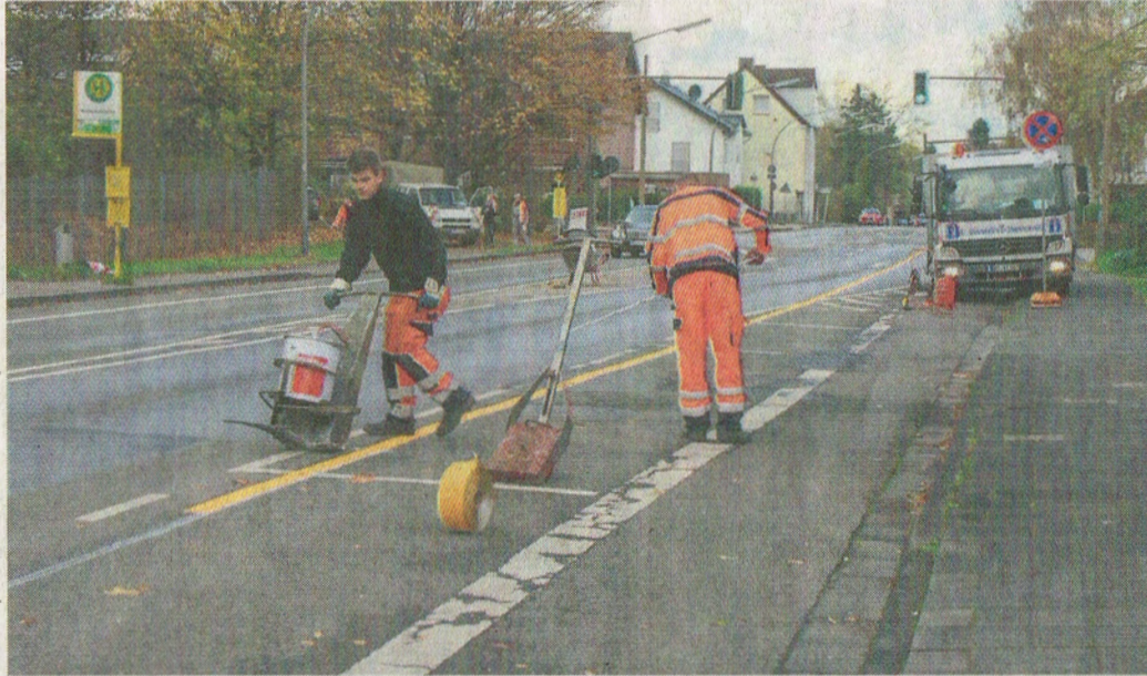
Die Baustelle in Höhe der Gesamtschule wurde gestern eingerichtet. Voraussichtlich fünf Wochen lang wird hier gearbeitet.
